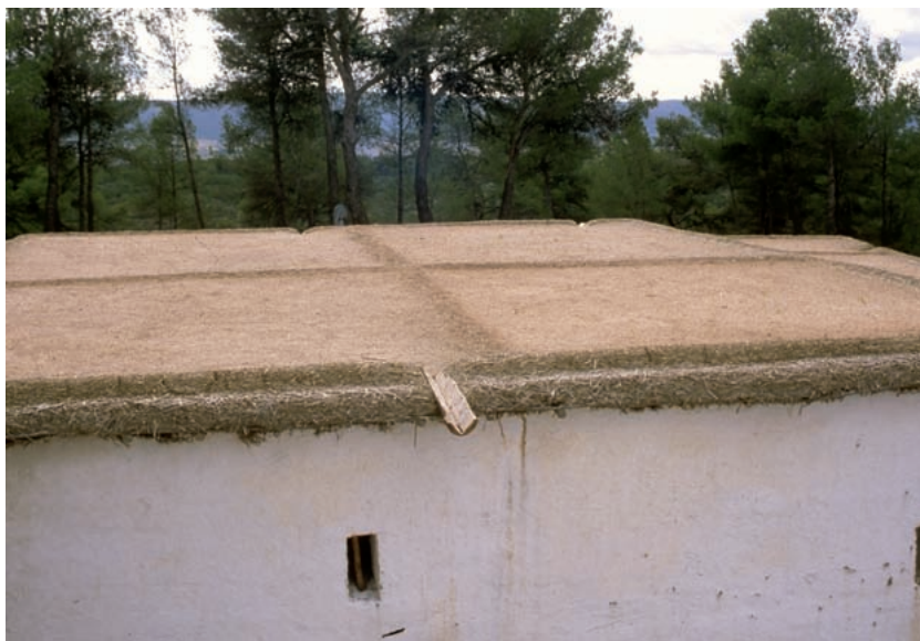
19. Reparación del techo, introduciendo los cuadrantes y aumentando el desnivel para facilitar la salida del agua (año 1999).
