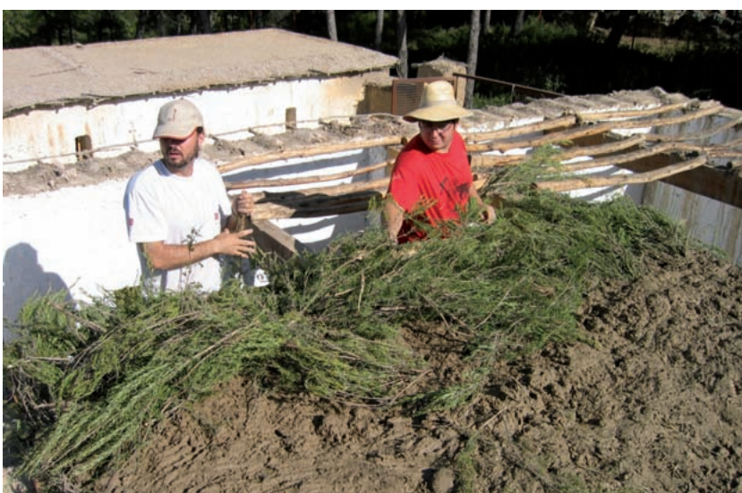
21. 1. Sustitución del techo incorporando rollizos más gruesos. 2. Trabajos de sustitución del techo en el momento de colocar la capa de romero y barro sobre los rollizos (otoño de 2004).
